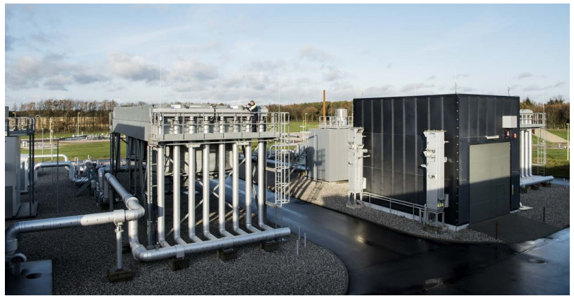
Kompressorbygning og fritstående køleenhed
